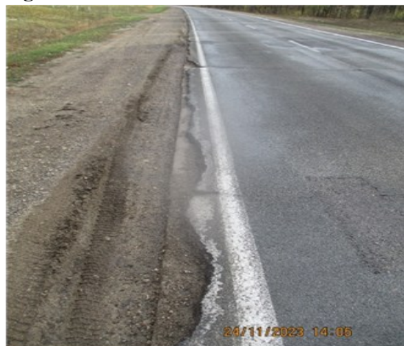
Figură 4-4: Starea drumului la Km 64+000 . Rupturi de margine
