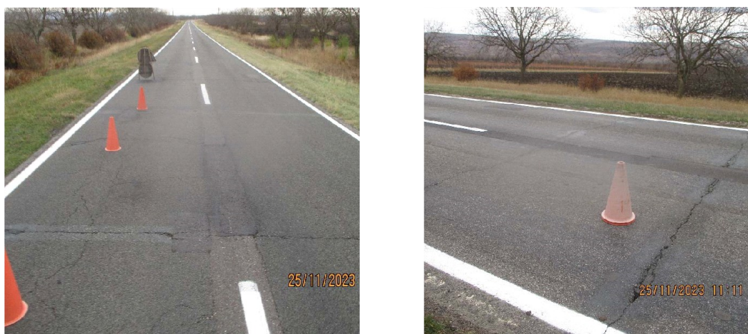
Figură 4-2: km 17+000, km 20+500. Crăpăturile transversale și longitudinale
