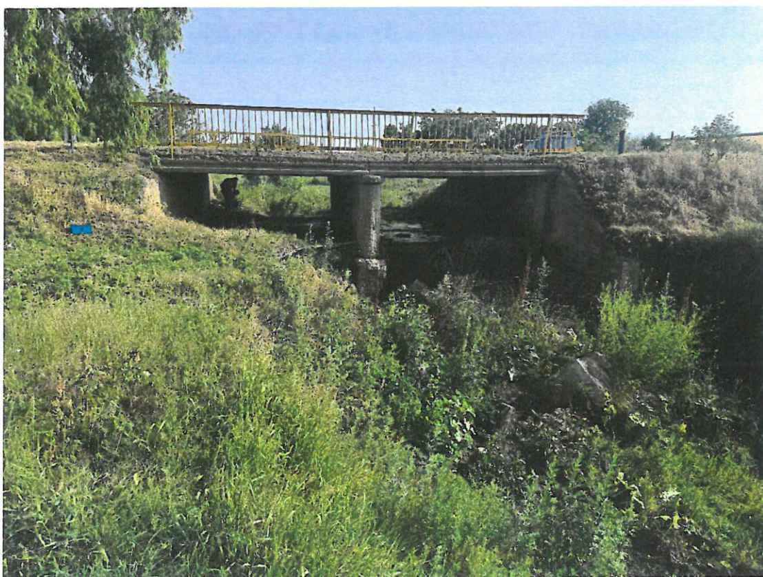
Fotografia 2. Vedere din aval a podului. Coborârea etiajului în zona podului, adâncirea talvegului și afuierea infrastructurilor, albie cu vegetație abundentă.
