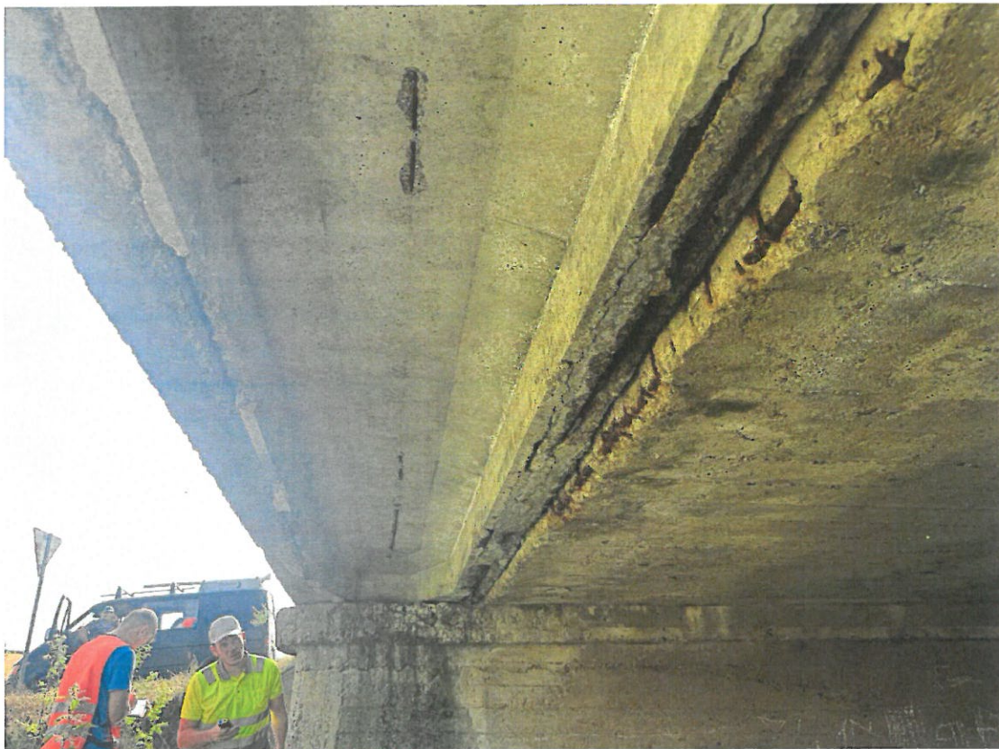
Fotografia 13. Suprastructura. Intradusul plăcilor cu infiltrații, strat de acoperire al armaturii căzut, armatură la vedere afectată puternic de coroziune, beton degradat prin carbonatare.
