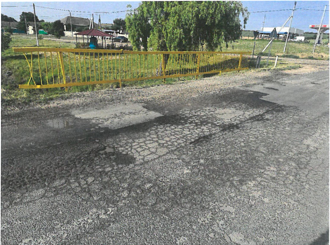
Fotografia 4. Calea podului, Evacuarea proastă a apelor, degradarea asfaltului, degradarea parapetului pietonal.
