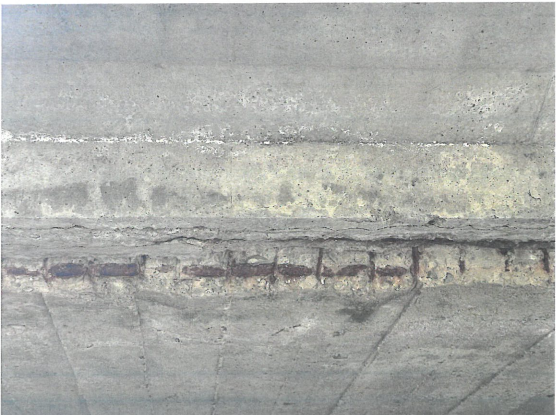
Fotografia 12. Suprastructura. Intradosul plăcilor cu infiltrații, strat de acoperire al armaturii căzut, armatură la vedere afectată puternic de coroziune, beton degradat prin carbonatare.
