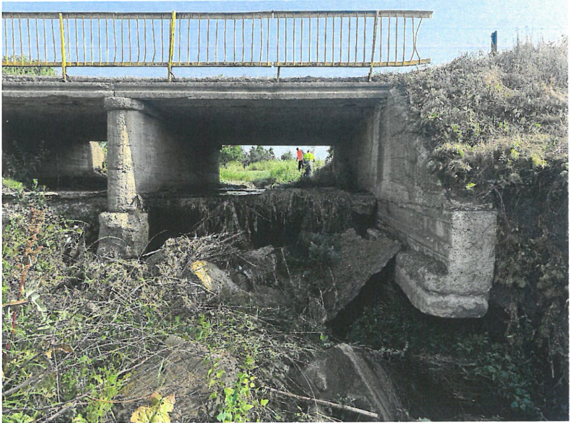
Fotografia 7. Infrastructura (deschiderea 1). Degradarea lucrărilor de protecție a albiei, modificarea regimului hidraulic, coborârea etiajului în zona podului, adâncirea talvegului și afilierea fundației.
