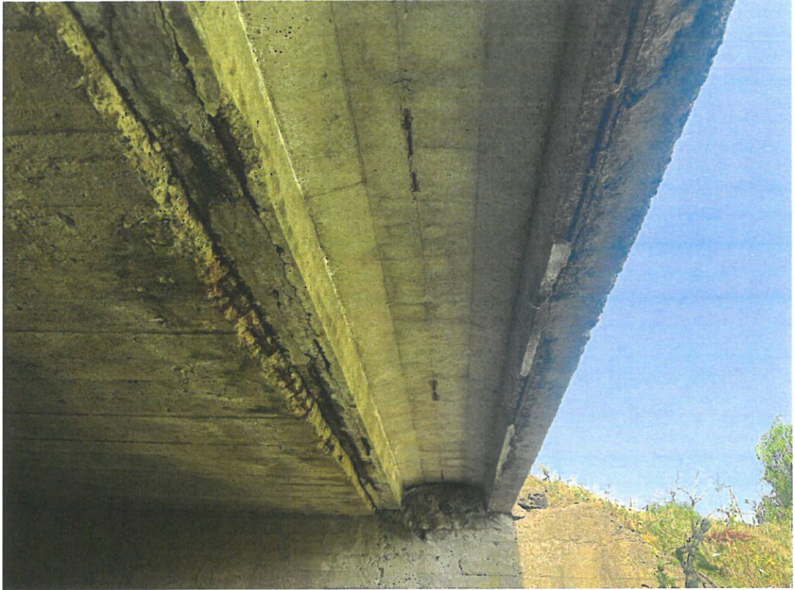
Fotografia 9. Suprastructura. Infiltrații la intrados, coroziunea armaturii, crăpături și pete de rugină orientate pe direcția acesteia, strat de acoperire căzut.
