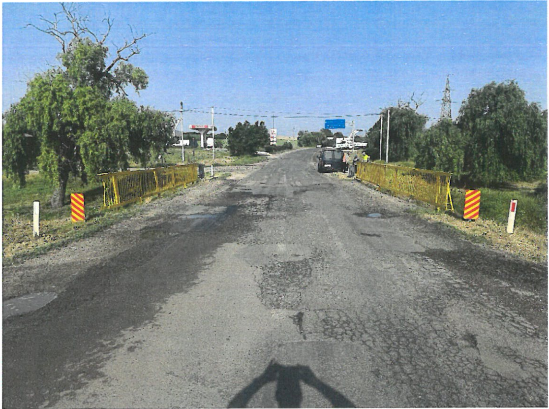
Fotografia 3. Calea podului. Lipsă parapetului de siguranță, evacuarea proastă a apelor, degradarea îmbrăcămintei asfaltice.
