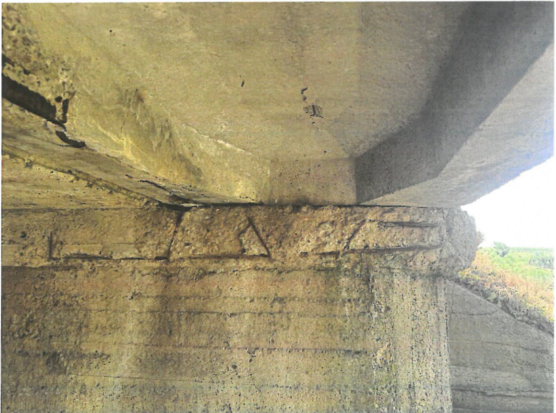
Fotografia 10. Suprastructura (detaliu de rezemare). Infiltrații, banchetă cu betonul degradat, strat de acoperire căzut, coroziunea armaturii.
