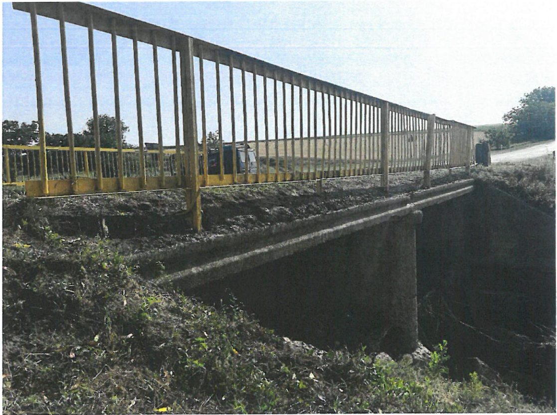
Fotografia 5. Suprastructura. Grosime exagerată a sistemului rutier pe suprastructură.
