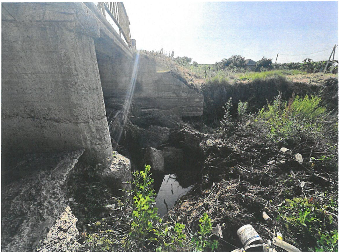
Fotografia 6. Infrastructura. Degradarea lucrărilor de protecție a albiei în aval, albie cu resturi menajere și vegetație.
