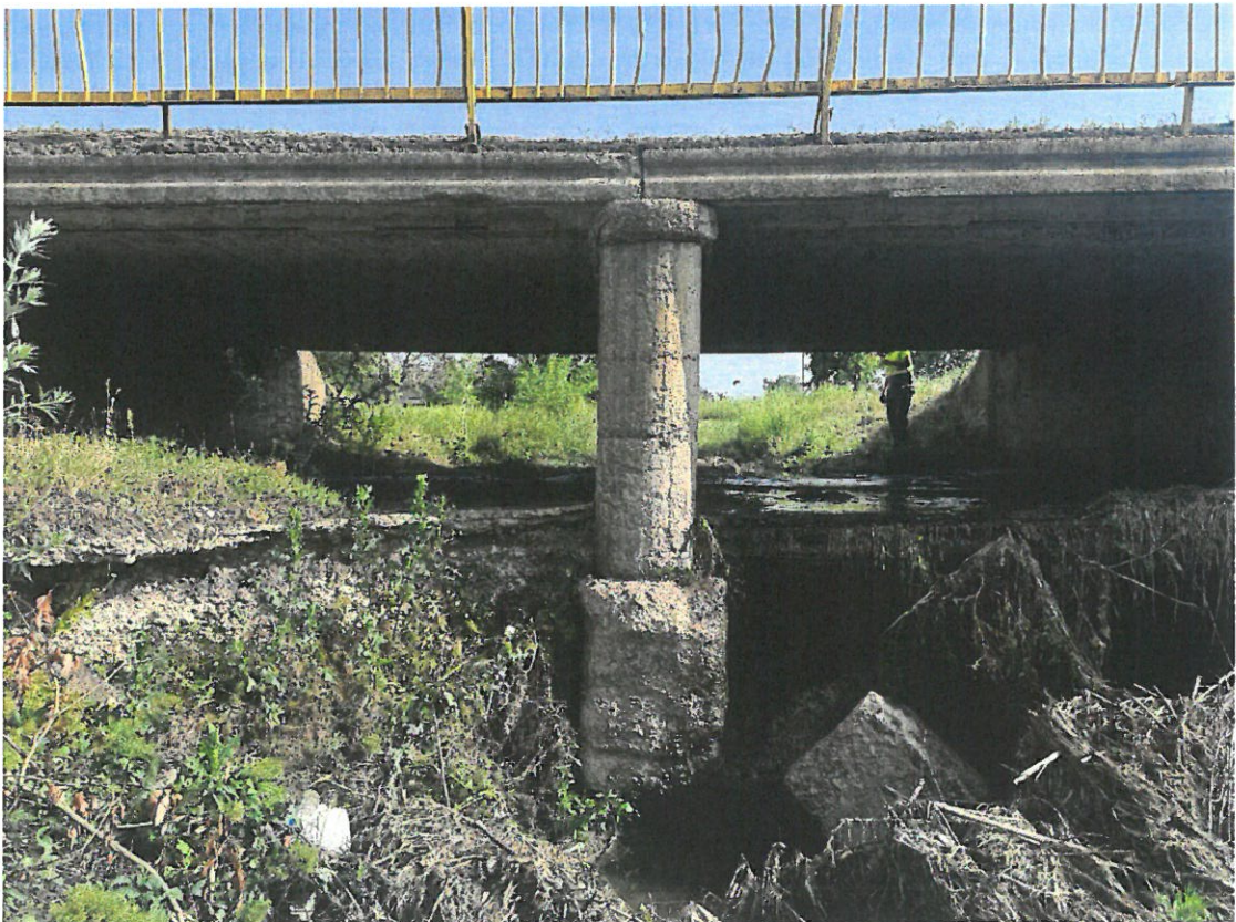
Fotografia 8. Infrastructura. Degradarea lucrărilor de protecție a albiei, coborârea etiajului în zona podului, adâncirea talvegului și afilierea fundației.
