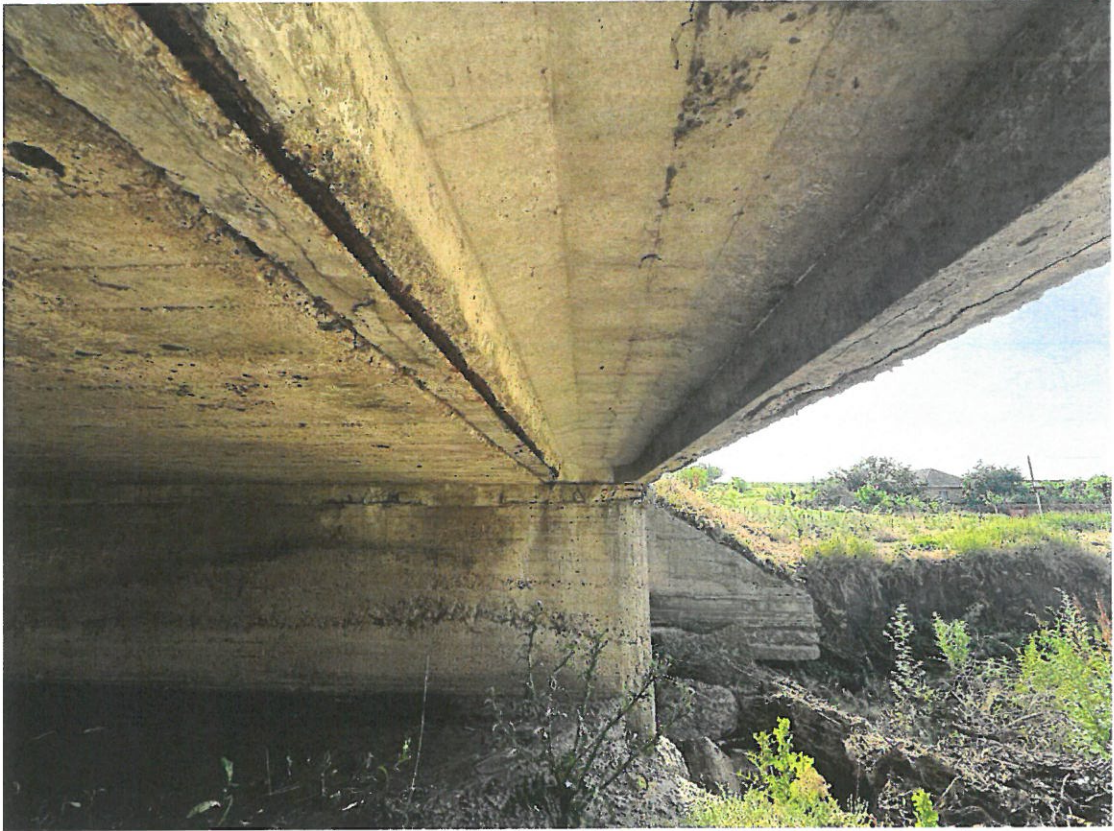
Fotografia 11. Suprastructura. Intradosul plăcilor cu infiltrații, strat de acoperire al armaturii căzut, armatură la vedere afectată puternic de coroziune, beton degradat prin carbonatare.
