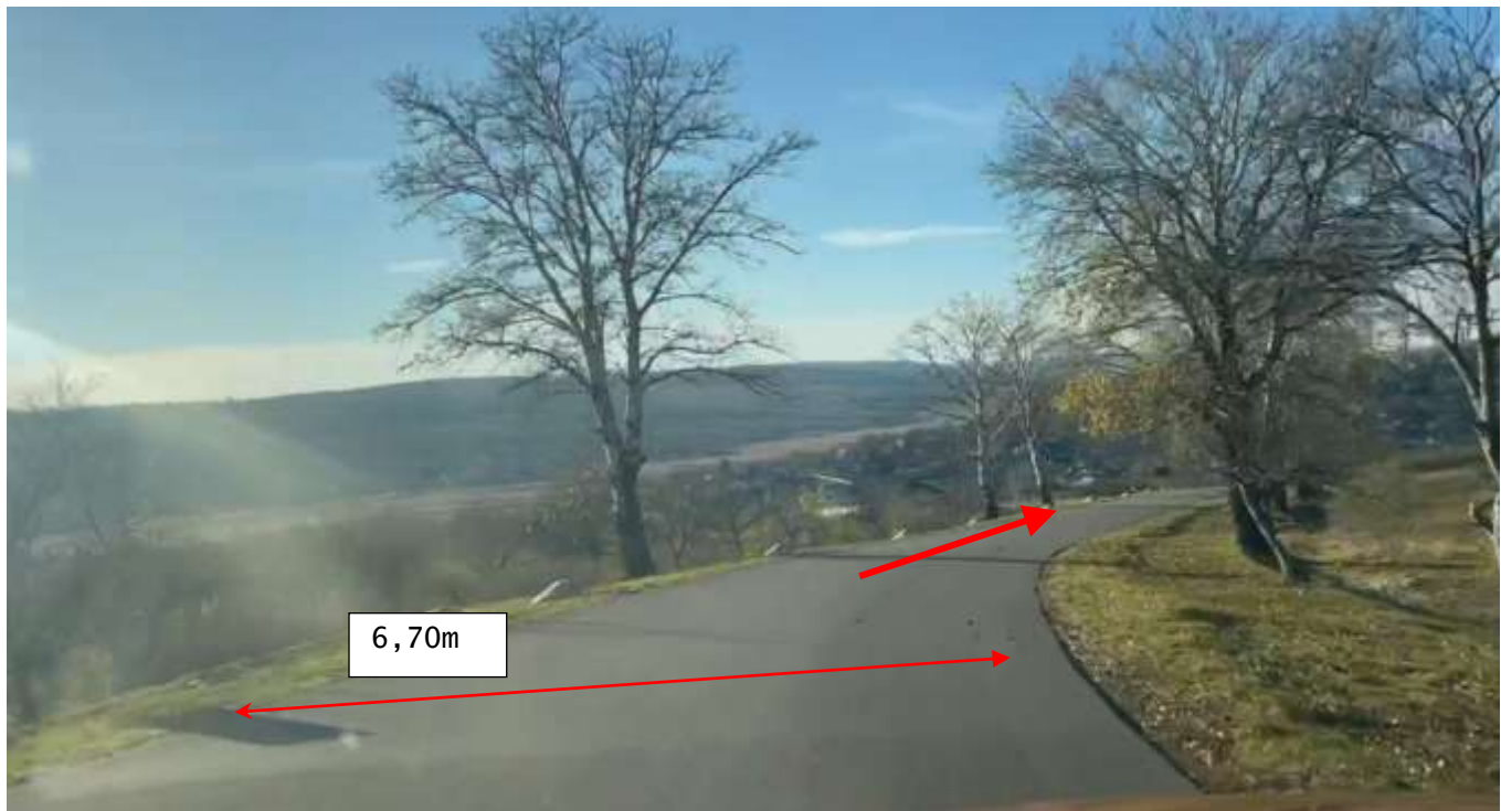
Figura 48. Km 9+275. Sector reabilitat în cadrul proiectului de reparație a drumului, sistemul rutier existent din beton asfaltic în stare satisfăcătoare. Lățimea carosabilului existent ~6.00 m cu acostamente neconsolidate cu piatră spartă cu depuneri locale de namol. Lipsește șanțurile laterale cu consolidare conform tipurilor.
