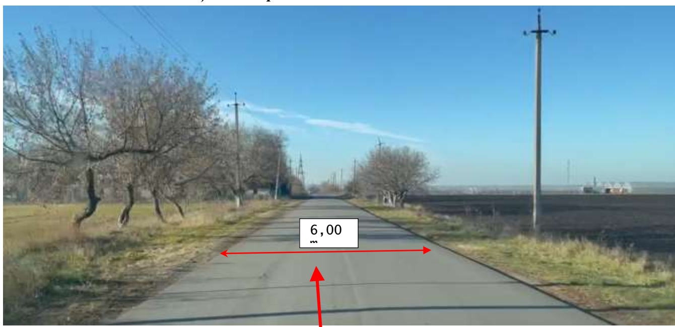
Figura 12. Km 1+300. Sector reabilitat în cadrul proiectului de reparație a drumului, sistemul rutier existent în stare bună. Lățimea carosabilului existent ~6.00 m cu acostamente neconsolidate cu piatră spartă cu depuneri locale de namol.
