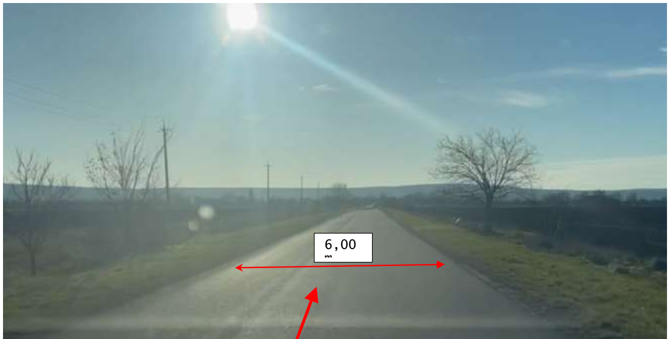
Figura 5. Km 0+675. Starea sistemului rutier din beton asfaltic în stare existent bună. Fără deformații. Lățimea carosabilului existent ~6.00 m cu acostamente neconsolidate cu piatră spartă cu depuneri locale de namol.
