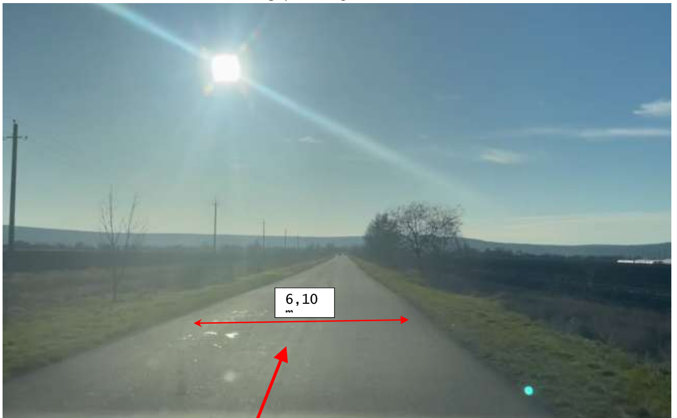
Figura 4. Km 0+350. Starea sistemului rutier existent bună. Fără deformații. Lățimea carosabilului existent ~6.00 m cu acostamente neconsolidate cu piatră spartă cu depuneri locale de namol.
