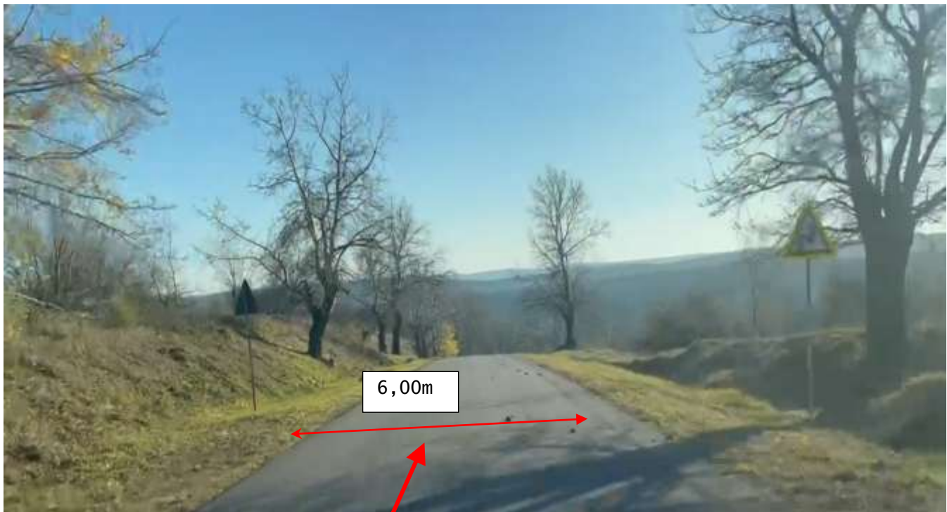
Figura 47. Km 8+800. Sector reabilitat în cadrul proiectului de reparație a drumului, sistemul rutier existent din beton asfaltic în stare satisfăcătoare. Lățimea carosabilului existent ~6.00 m cu acostamente neconsolidate cu piatră spartă cu depuneri locale de namol. Lipsesc șanțurile laterale cu consolidare conform tipurilor.
