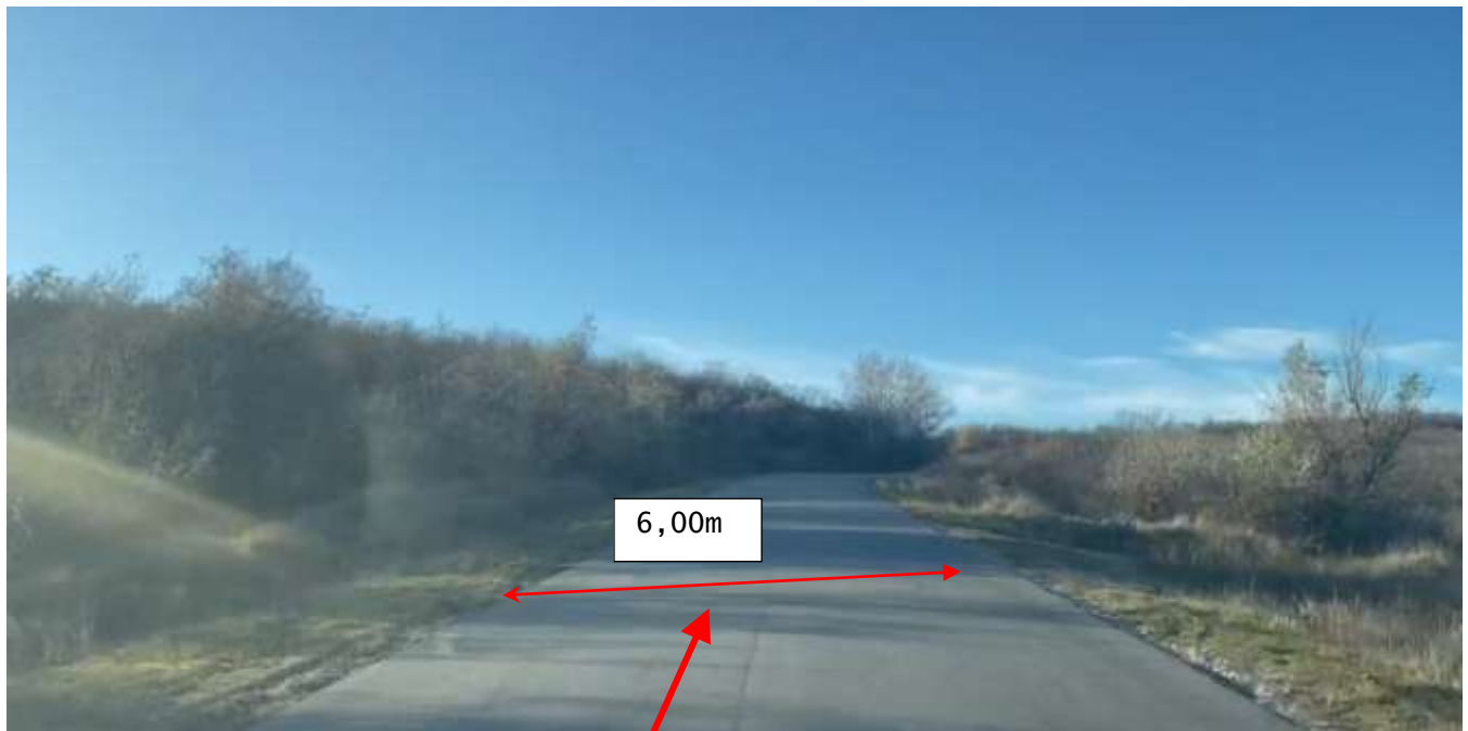
Figura 42. Km 7+200. Sector reabilitat în cadrul proiectului de reparație a drumului, sistemul rutier existent din beton asfaltic în stare satisfăcătoare. Lățimea carosabilului existent ~6.00 m cu acostamente neconsolidate cu piatră spartă cu depuneri locale de namol. Lipsește șanțurile laterale cu consolidare conform tipurilor.
