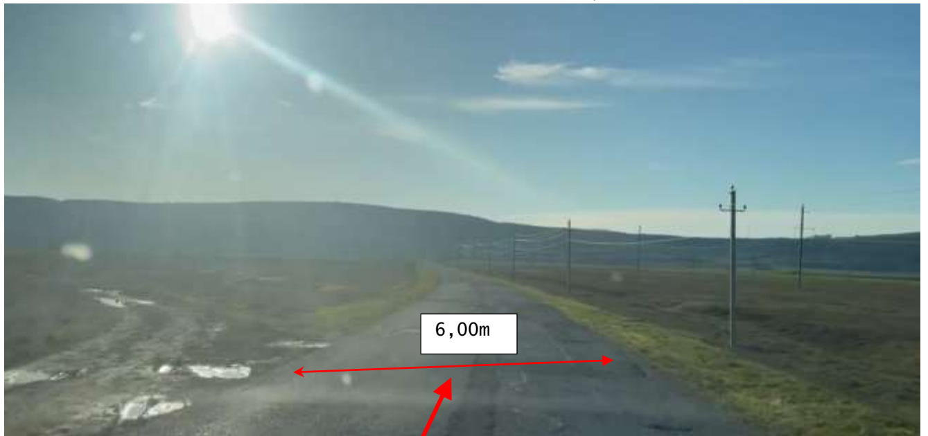
Figura 25. Km 4+250. Sistemul rutier existent beton vibrocilindrat în stare rea. Lățimea carosabilului existent ~6.00 m cu acostamente neconsolidate cu piatră spartă cu depuneri locale de namol. Pentru a repara acest sector au fost executate lucrări de plombare a rostului longitudinal și pe alocuri și transversal.
