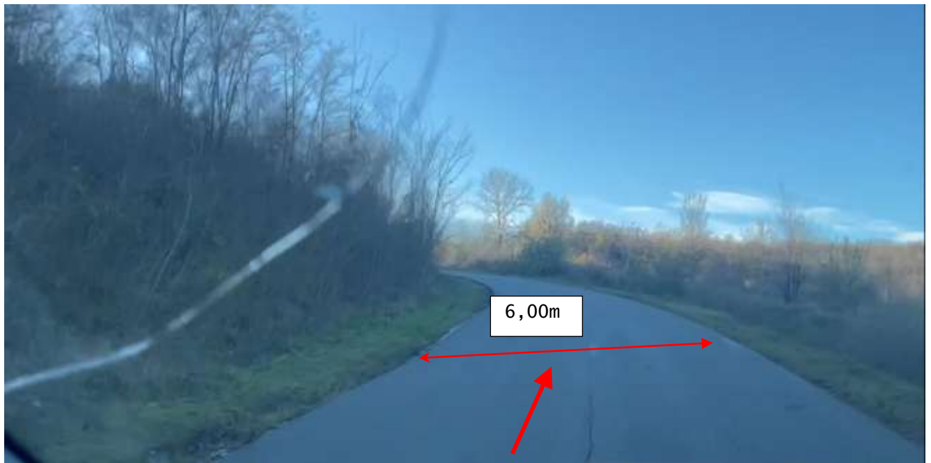
Figura 43. Km 7+425. Sector reabilitat în cadrul proiectului de reparație a drumului, sistemul rutier existent din beton asfaltic în stare satisfăcătoare. Lățimea carosabilului existent ~6.00 m cu acostamente neconsolidate cu piatră spartă cu depuneri locale de namol. Lipsește șanțurile laterale cu consolidare conform tipurilor. Se întâlnește curbă în plan cu R=200 și în profil longitudinal de tip convexe cu R=1500 astfel unghiul de vizibilitate este limitat. Sunt necesare măsuri de sporire a unghiului de vizibilitate,
