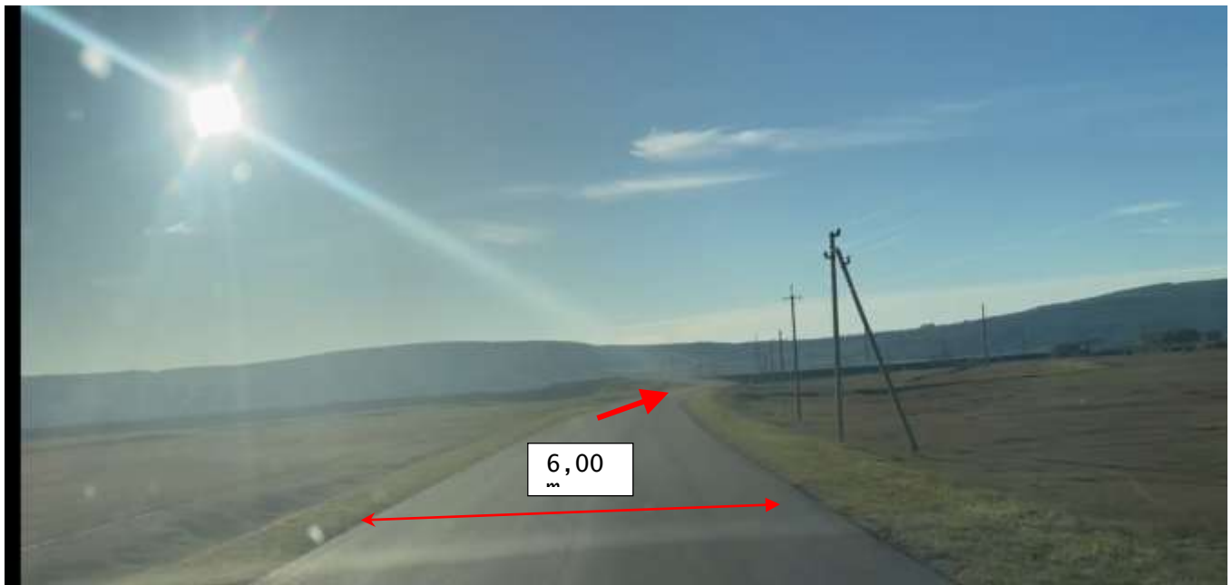
Figura 21. Km 3+675. Sector reabilitat în cadrul proiectului de reparație a drumului, sistemul rutier existent beton asfaltic în stare bună. Lățimea carosabilului existent ~6.00 m cu acostamente neconsolidate cu piatră spartă cu depuneri locale de namol. Evacuarea apelor de pe carosabil sunt direcționate în acostamentele drumului și piciorul taluzului.
