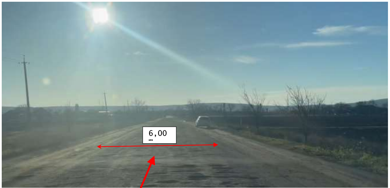
Figura 7. Km 0+850. Sector degradat sistemul rutier existent în stare rea. Lățimea carosabilului existent ~6.00 m cu acostamente neconsolidate cu piatră spartă cu depuneri locale de namol. Au fost executate lucrări de frezare a stratului de rulare deoarece acesta era acoperit cu gropi în proporție de 90%.
