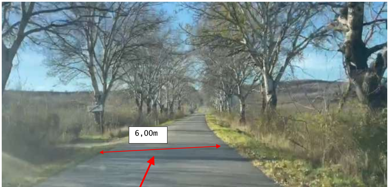
Figura 40. Km 6+690. Sector reabilitat în cadrul proiectului de reparație a drumului, sistemul rutier existent din beton asfaltic în stare bună. Lățimea carosabilului existent ~6.00 m cu acostamente neconsolidate cu piatră spartă cu depuneri locale de namol. Sfirșitul loc. Clișova amenajată tangențial pe partea stîngă a drumului G66.
