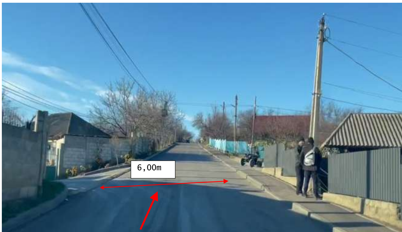
Figura 58. Km 10+475. Sector reabilitat în cadrul proiectului de reparație a drumului, sistemul rutier existent din beton asfaltic în stare satisfăcătoare. Partea carosabilă este mărginită cu piatră de bordură pe ambele părți și trotuar pe partea dreaptă.
