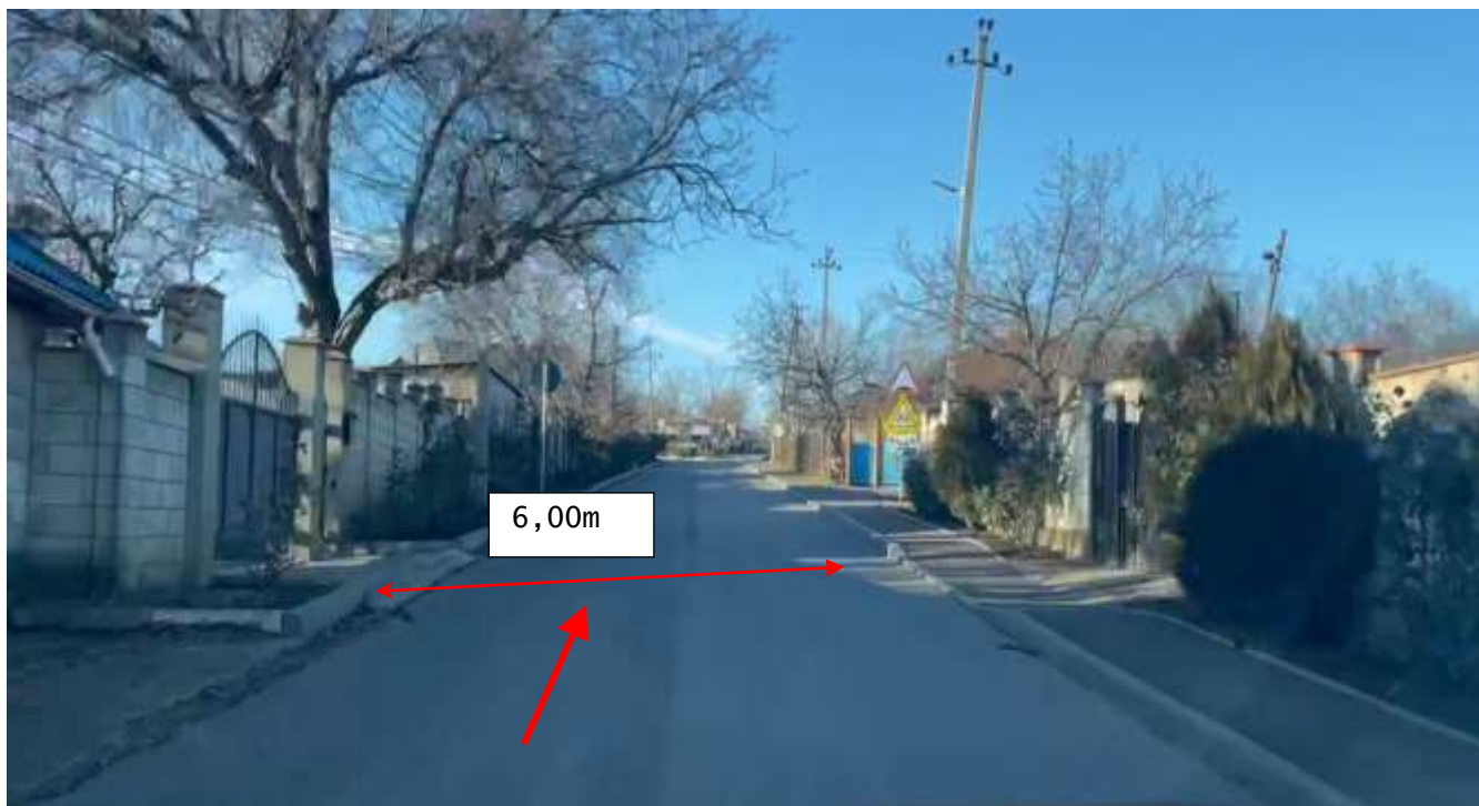
Figura 59. Km 10+700. Sector reabilitat în cadrul proiectului de reparație a drumului, sistemul rutier existent din beton asfaltic în stare satisfăcătoare. Partea carosabilă este mărginită cu piatră de bordură pe ambele părți și trotuar pe partea dreaptă.
