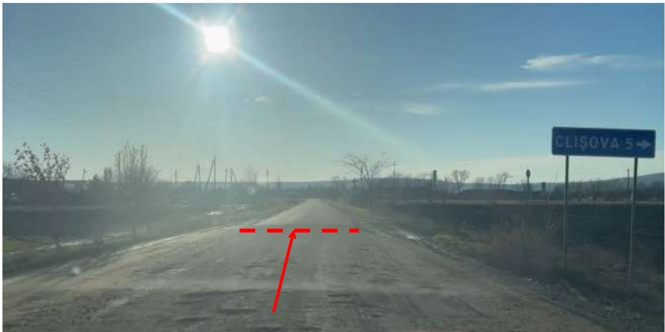
Figura 9. Km 1+105,5. Sfârșit sector degradat sistemul rutier existent beton asfaltic în stare în stare rea. Lățimea carosabilului existent ~6.00 m cu acostamente neconsolidate cu piatră spartă cu depuneri locale de namol. Au fost executate lucrări de frezare a stratului de rulare deoarece acesta era acoperit cu gropi în proporție de 90%.
