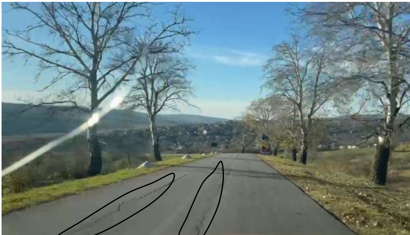
Figura 50. Km 9+350. Tasări longitudinale pe lungimea 100 m în axul drumului datorată necompactării corespunzătoare a patului drumului sau a infiltrării apelor pluviale de pe versanții din amonte drumului (lipsește șanțul pentru evacuarea apelor meteorice).
