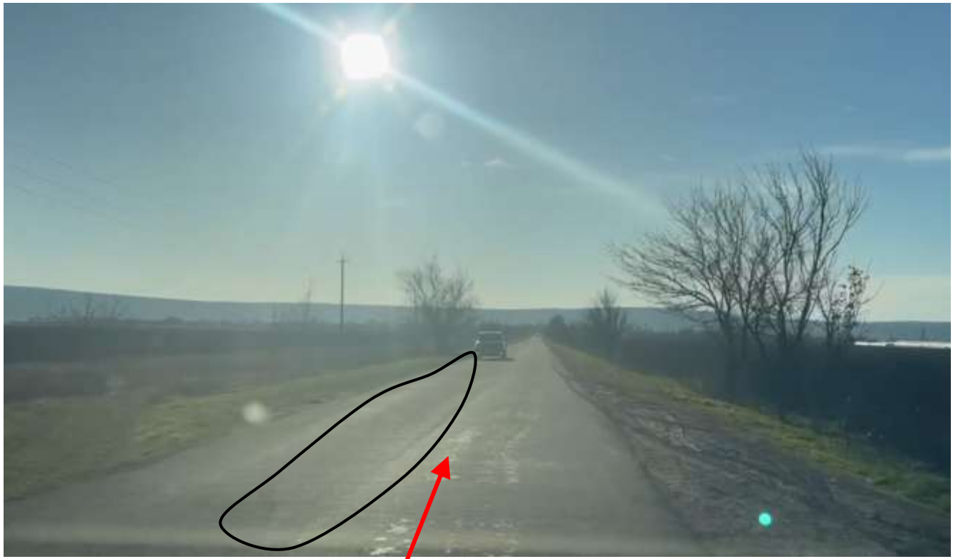
Figura 3. Km 0+150. Prezența fisurilor de mici dimensiuni longitudinale și transversale, prezenta fâgașelor longitudinale.
