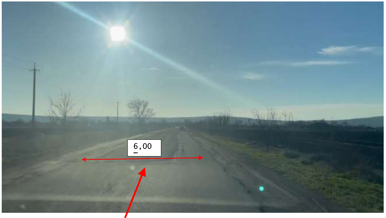
Figura 6. Km 0+750. Început sector degradat sistemul rutier existent în stare rea. Lățimea carosabilului existent ~6.00 m cu acostamente neconsolidate cu piatră spartă cu depuneri locale de namol. Au fost executate lucrări de frezare a stratului de rulare deoarece acesta era acoperit cu gropi în proporție de 90%.
