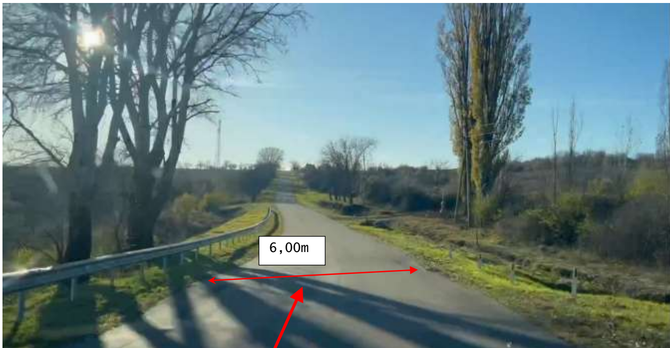
Figura 46. Km 8+170. Sector reabilitat în cadrul proiectului de reparație a drumului, sistemul rutier existent din beton asfaltic în stare satisfăcătoare. Lățimea carosabilului existent ~6.00 m cu acostamente neconsolidate cu piatră spartă cu depuneri locale de namol. Tasare în patul drumului în avalul podetului Km 8+166,97. Degradare apărută în urma ploilor abundente din vara anului 2024.
