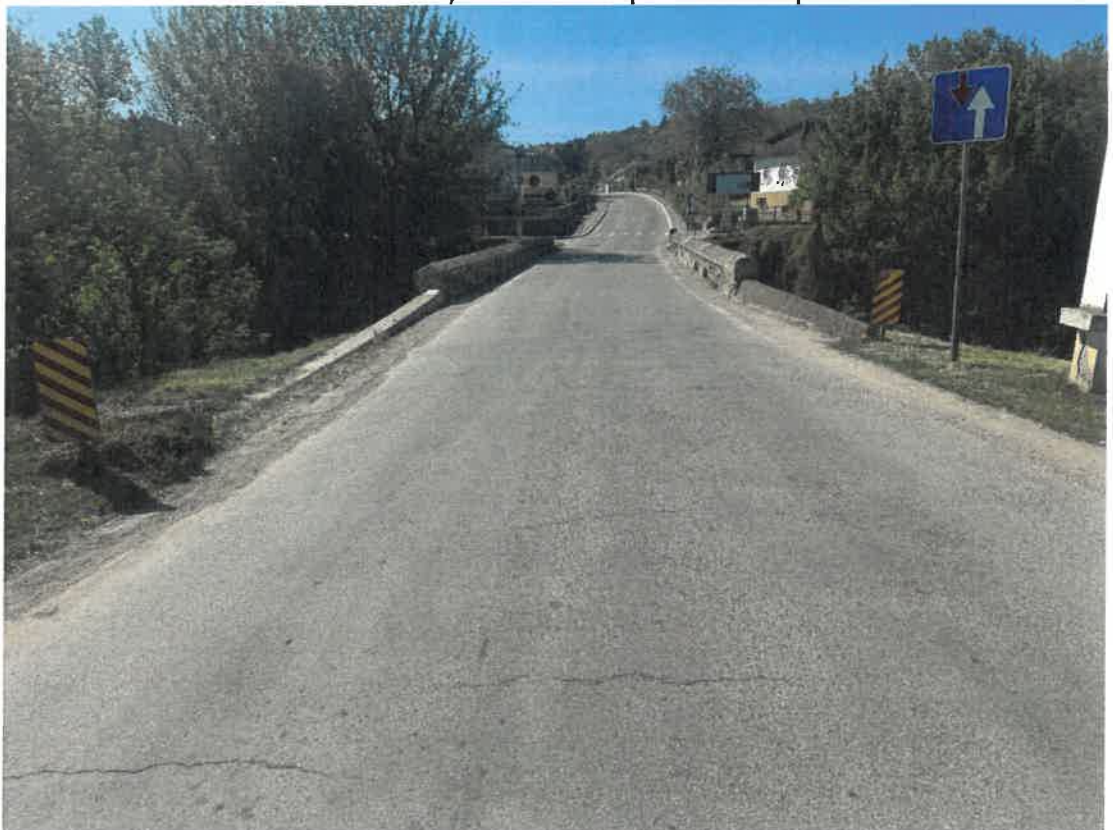
Fotografia 8. Vede cale pod, pe direcția Unguri: Lățime necorespunzătoare lipsa trotuarelor, evacuarea proastă a apelor, tasarea terasamentului.
