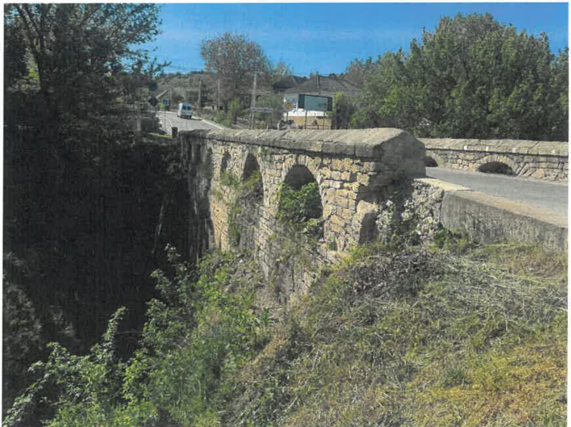
Fotografia 4. Vedere din aval a podului pe direcția Unguri: Infiltrații, degradarea parapetului, vegetație abundentă.
