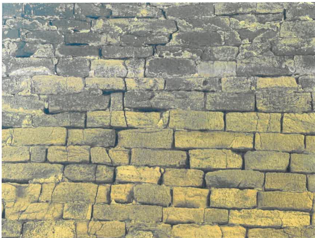
Fotografia 23. Detaliu boltă la intrados: Zidărie degradată prin eroziune, cu rosturi fără mortar de legătură, cu crăpături longitudinale prin rosturi și moloane.
