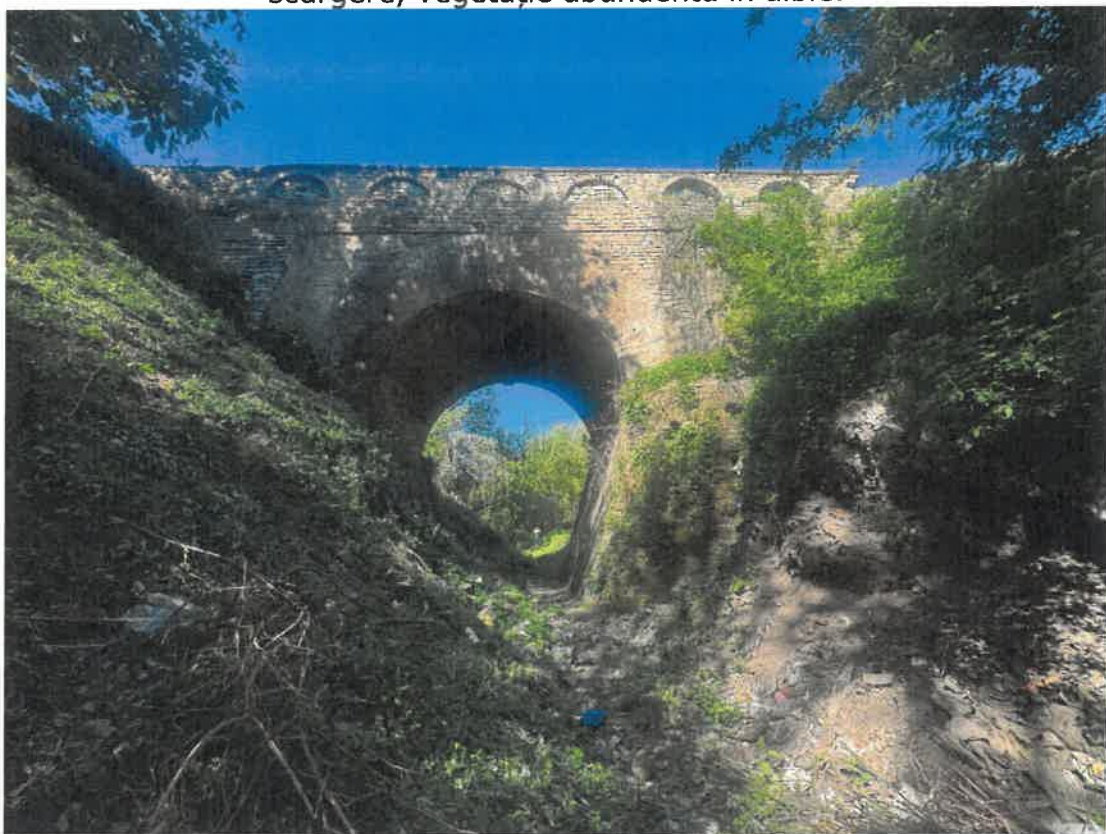
Fotografia 6. Vedere din aval a podului: Depuneri de material solid în secțiunea de scurgere, vegetație abundentă în albie.
