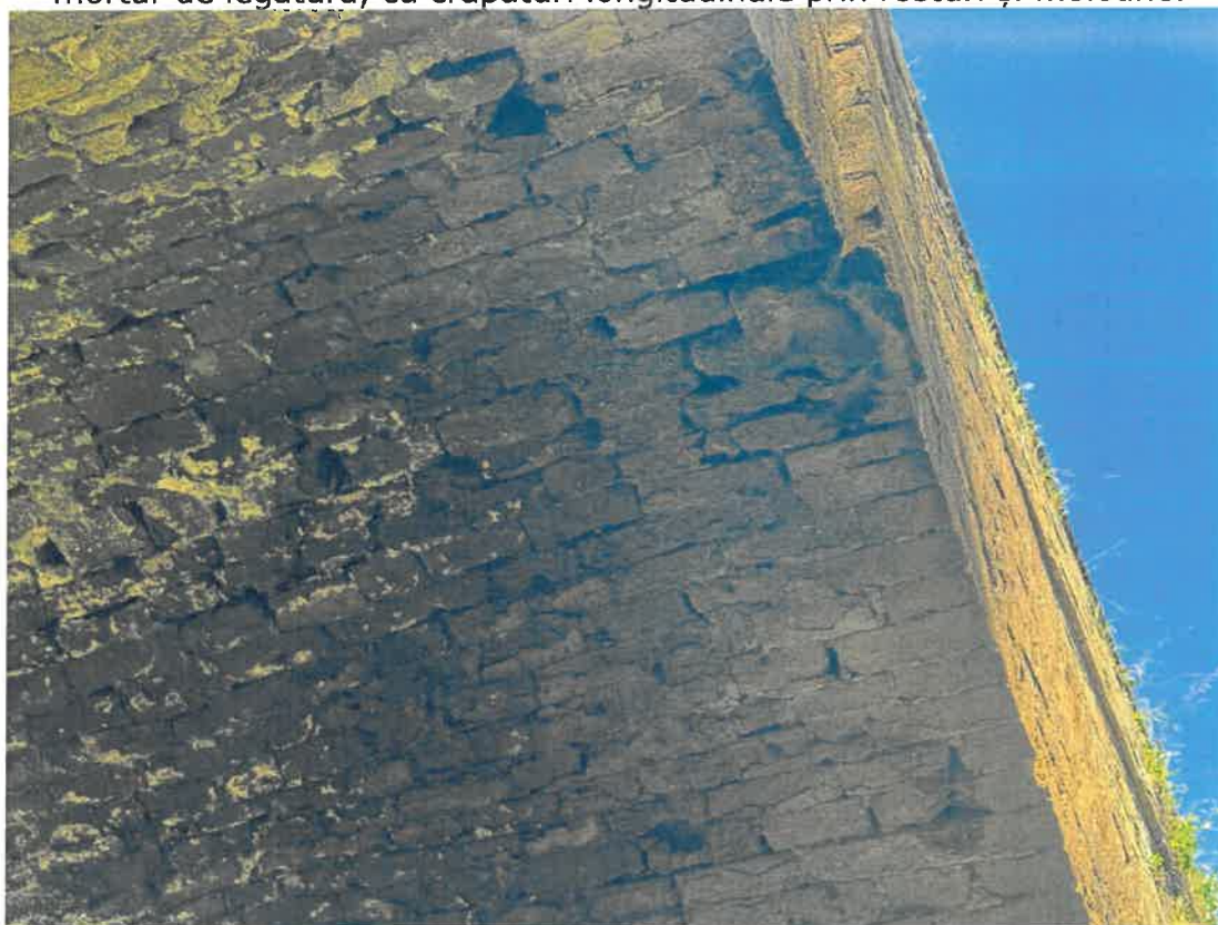
Fotografia 24. Detaliu boltă: Zidăria la Intrados cu infiltrații, eflorescențe, căderi de moloane.
