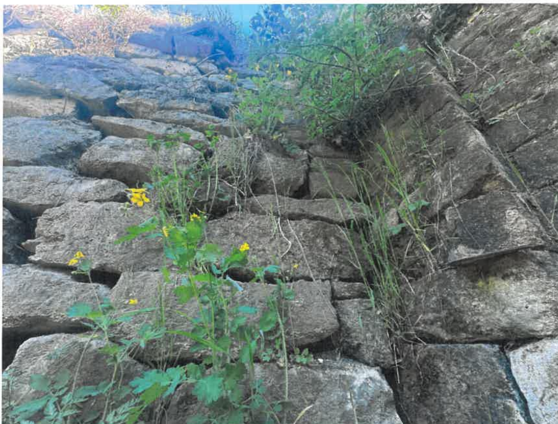
Fotografia 18. Detaliu zidărie culee nr.2 (amonte): Zidărie cu infiltrații, cu rosturi degradate, cu vegetație.
