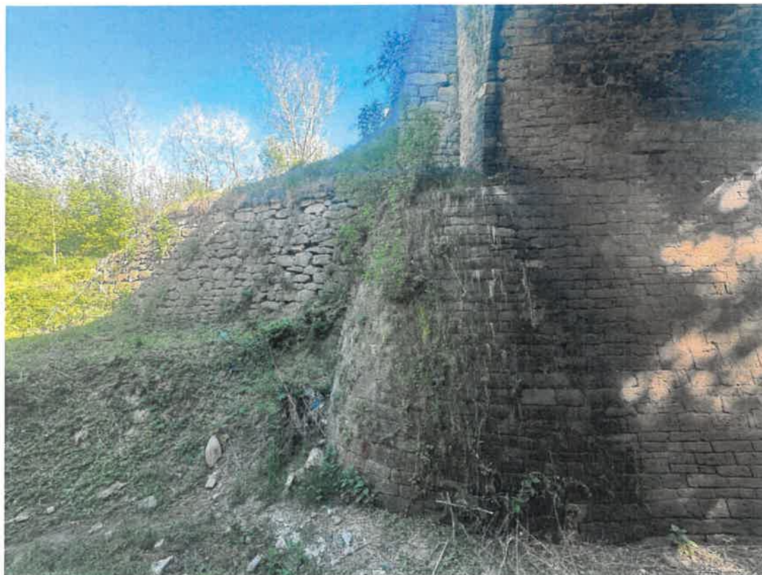
Fotografia 17. Detaliu culee nr.2 (amonte): Zidărie cu rosturi degradate, cu vegetație.
