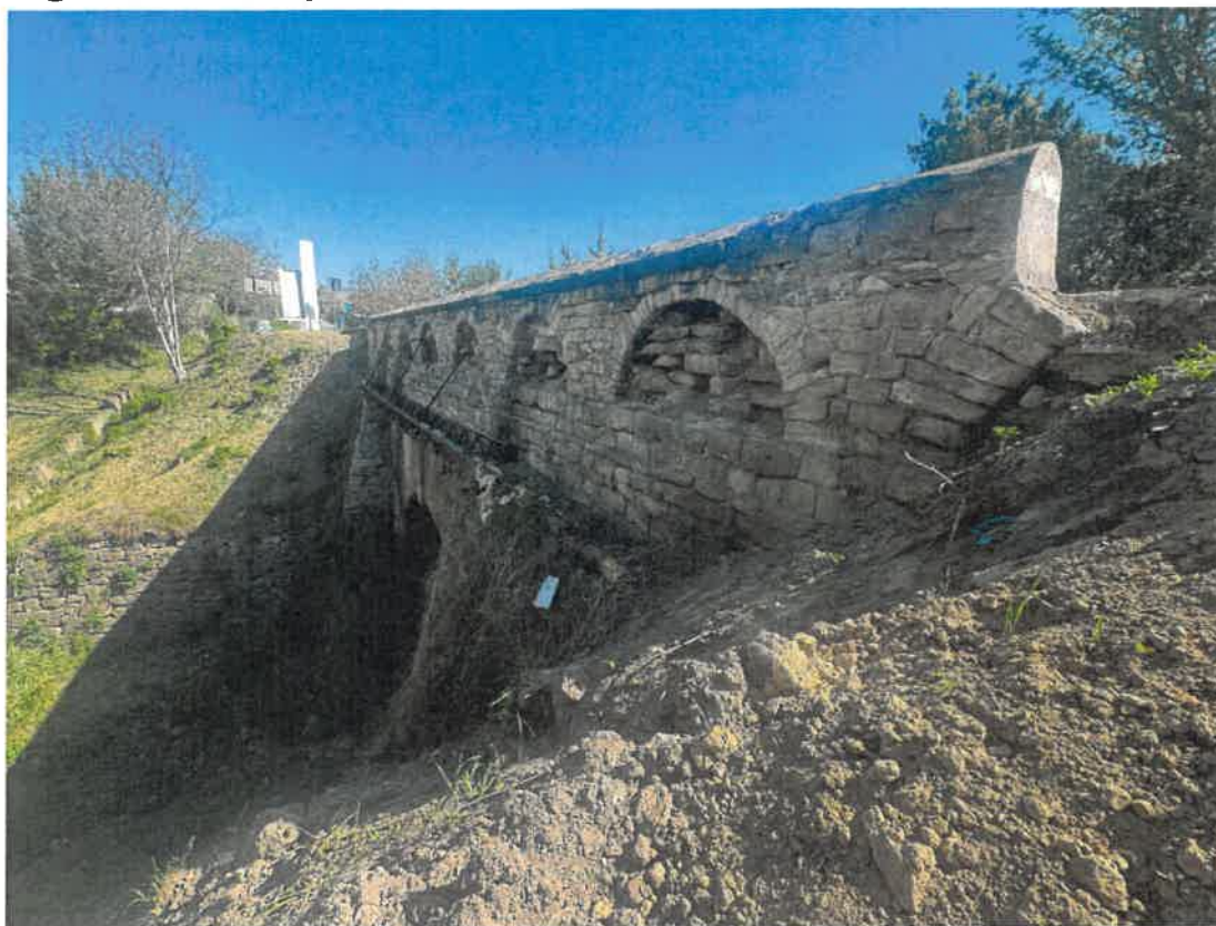
Fotografia 1. Vedere din amonte a podului pe direcția Otaci: Evacuarea proastă a apelor, infiltrații, degradarea zidăriei, prezenta rețelei de utilități pe pod.
