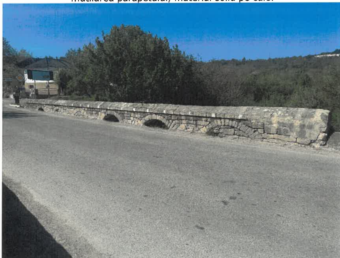
Fotografia 12. Vedere parapet pe stânga: Mutilarea parapetului, vegetație pe calea podului.
