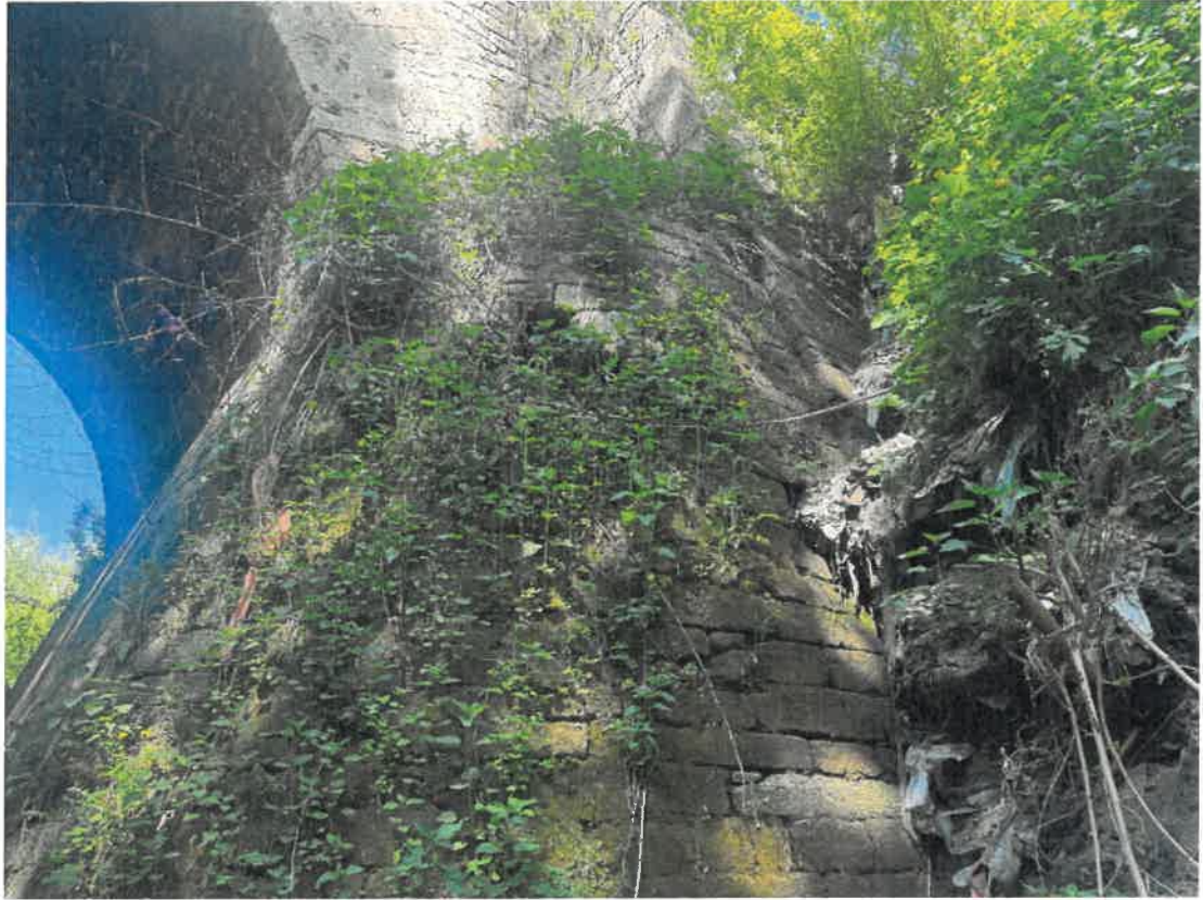
Fotografia 19. Detaliu elevație culee nr.2 (aval): Infiltrații masive, zidărie degradată, cu moloane desprinse, cu vegetație abundentă.
