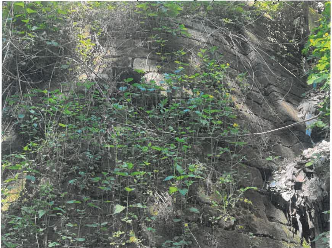
Fotografia 20. Detaliu culee nr.2 (aval): Zidărie degradată, cu moloane desprinse, cu vegetație abundentă.
