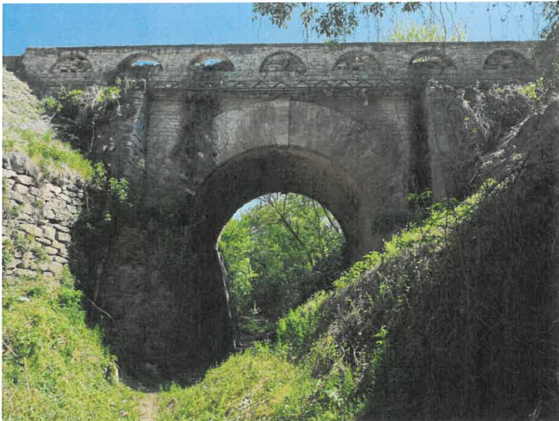
Fotografia 5. Vedere din amonte a podului. Depuneri de material solid în secțiunea de scurgere, vegetație abundentă în albie.
