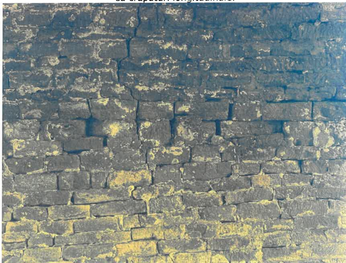
Fotografia 22. Detaliu intrados boltă: Zidărie, cu infiltrații masive, efloriscente, cu crăpături longitudinale, cu moloane crăpate, căzute.
