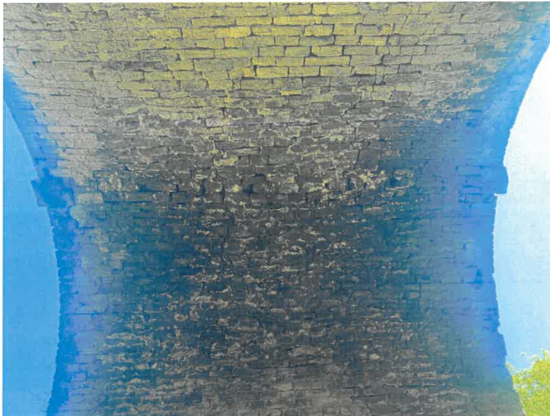
Fotografia 21. Detaliu boltă: Intradosul cu infiltrații, eflorescențe, cu rosturi degradate, cu crăpături longitudinale.
